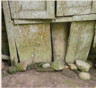
Sambungan papan kayu renggang dan bagian bawah kayu lembab terpapar hujan dan air tanah. Foto: Febriyanti S. (2025).
